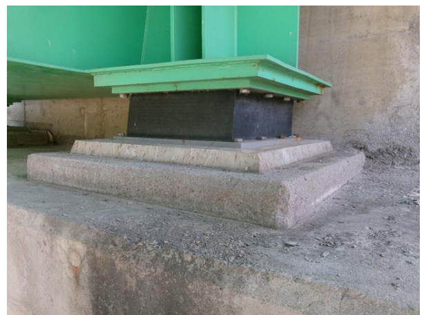
궁촌IC RAMP-B교 교량반침 A2-SH2 받침콘크리트 박리 2.0*0.2
