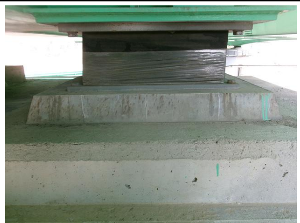
궁촌IC RAMP-B교 교량반침 P4-SH3 무수축물탈 균열 0.1/0.2*3EA
