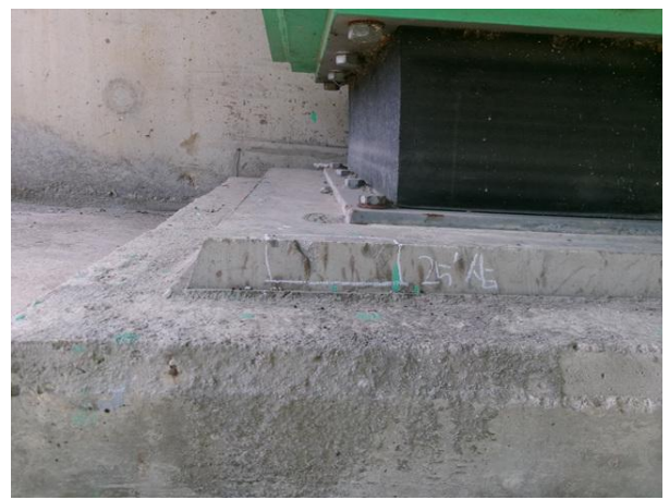
궁촌IC RAMP-B교 교량반침 A2-SH1 무수축물탈 박락 0.1*0.1
