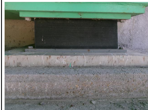
궁촌IC RAMP-B교 교량반침 A2-SH2 무수축물탈 균열 0.1/0.1*4EA
