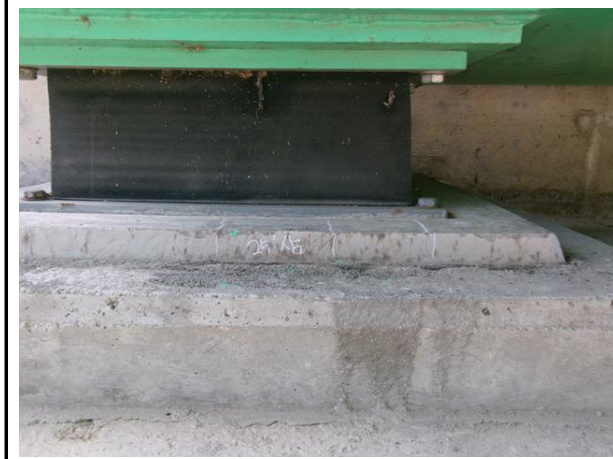
궁촌IC RAMP-B교 교량반침 A2-SH1 무수축물탈 균열 0.1/0.1*3EA
