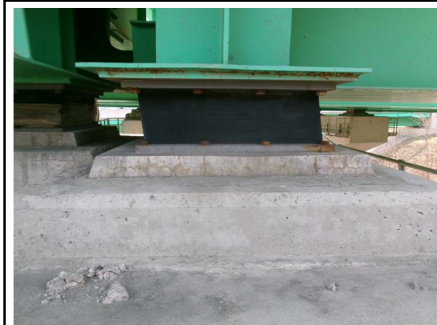
궁촌IC RAMP-B교 교량반침 P4-SH2 무수축물탈 망상균열 0.2*1.0(Cw=0.1mm)
